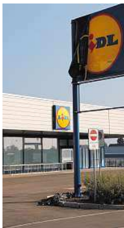
Der Lack bröckelt bereits vor der Eröffnung: Lidl-Filiale in Jona.
